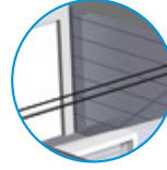
Potrubí s chladivem
